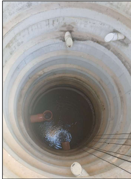
Figura 06: Poço de sucção.
