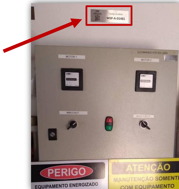
Figura 3: Placa de ativo do painel
