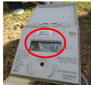
Fig. 03 – leitura do hidrômetro ultrassônico
